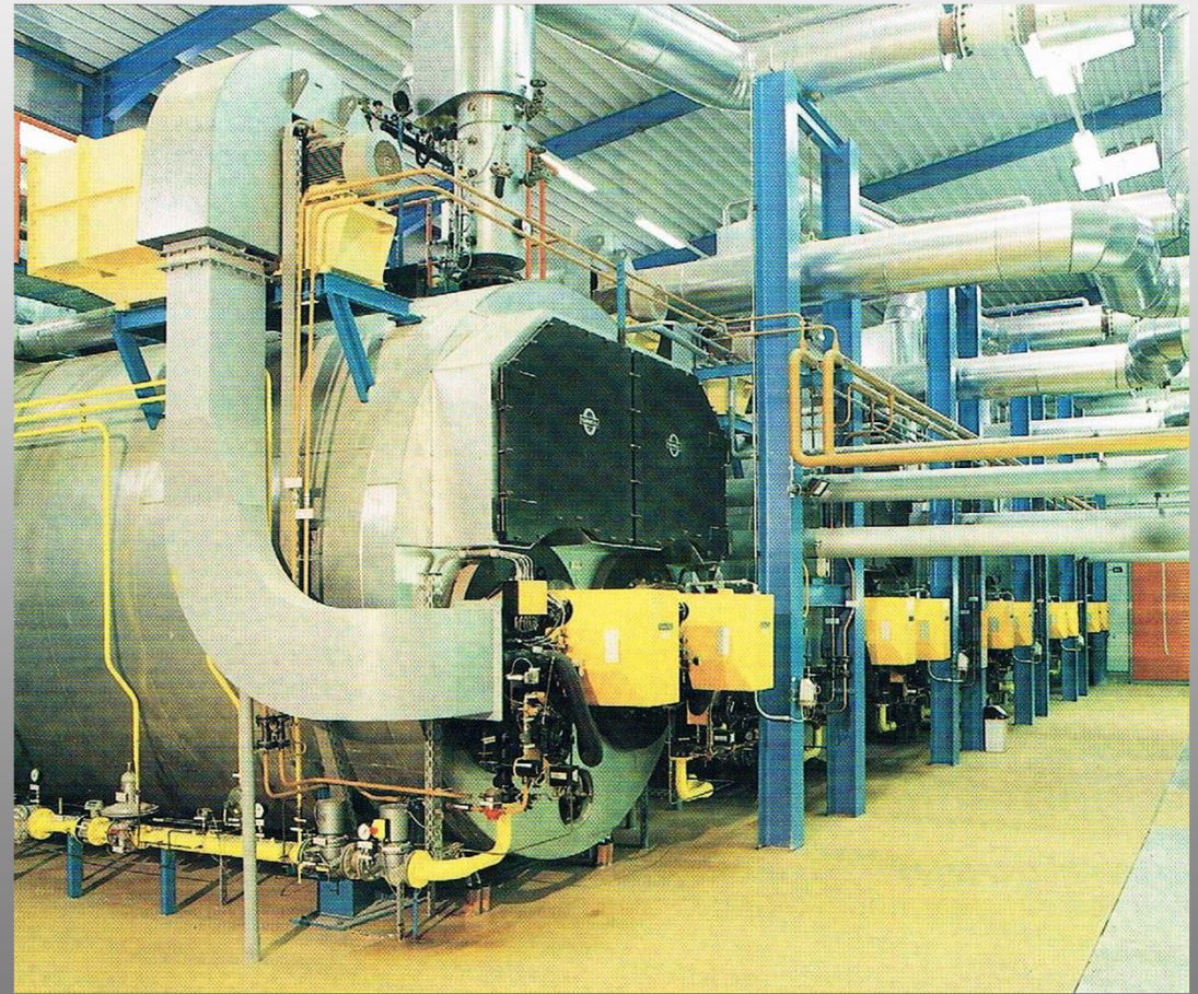
5 MW Dampferzeuger (Stromerzeugungsanlage)
