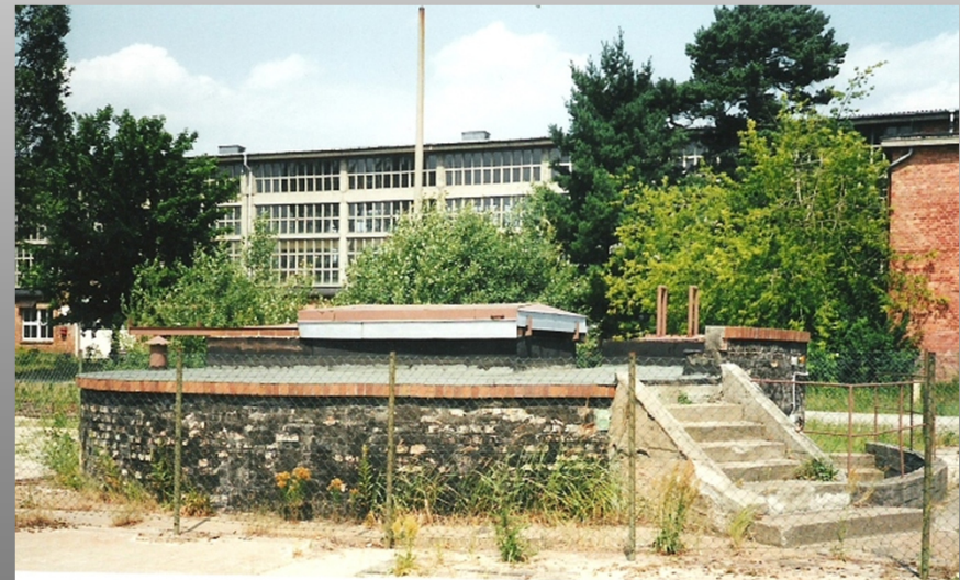
Hauptschmutzwasserpumpwerk an der Halle 2
