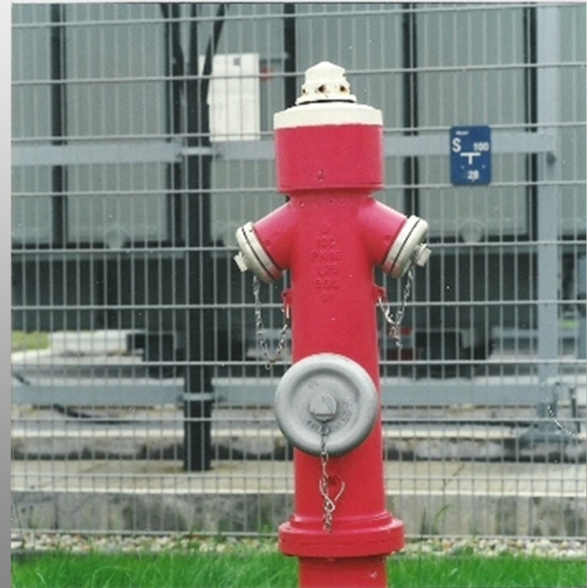
Oberflurhydrant zur Wasserentnahme im Brandfall
