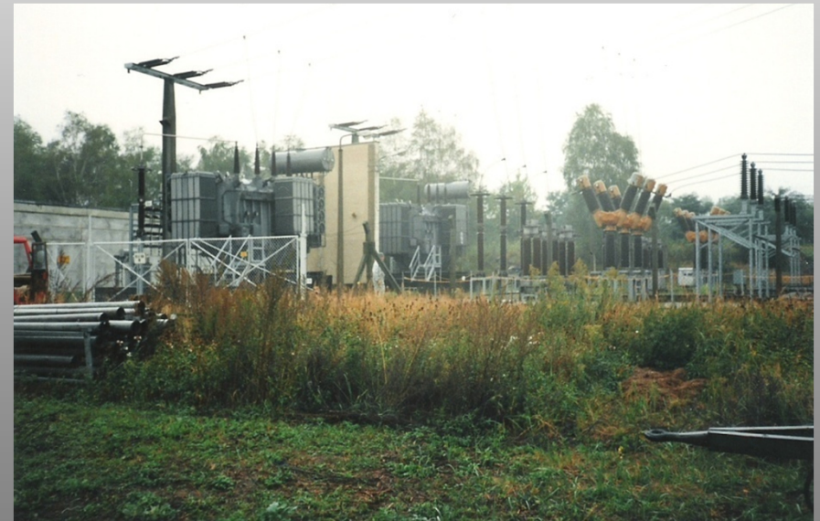
Transformatoren mit Stromzuführungsleitungen für 110/30 kV Umspannwerk
