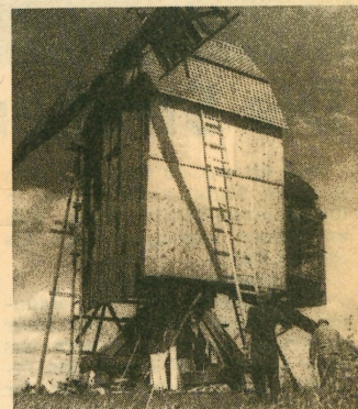
In einem desolaten Zustand be- fand sich die Tornauer Bock- windmühle, an deren Rekon- struktion H.-J. Zecher noch ar- beitet
